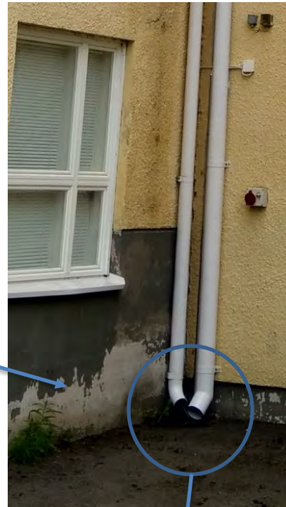
Kuva 11 Pihan kallistuksesta ja roiskevedestä aiheutunutta vauriota.
