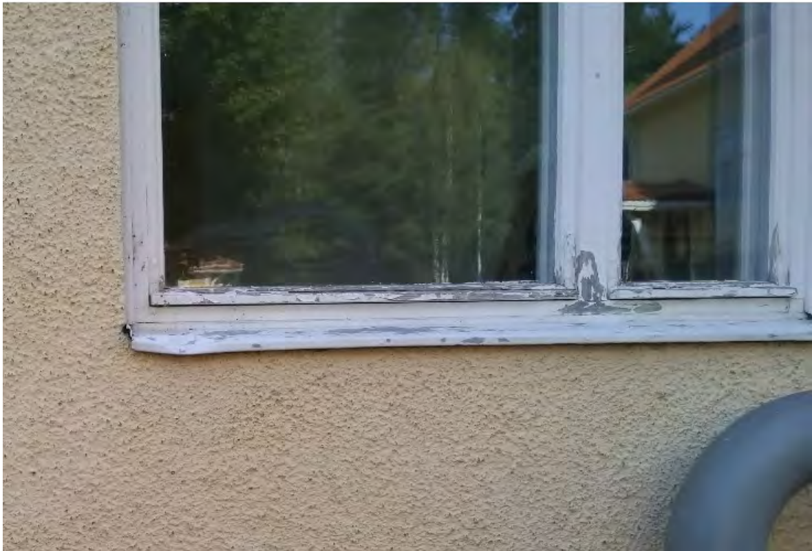
Kuva 35 Kivikoulun A-osan vanhat ikkunat: maali rapistunut ja vesipeltien kallistukset puutteelliset.
