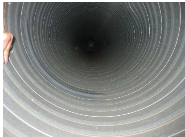
Kuva 67 Tuloilmakanava, puukoulu C-osa.
