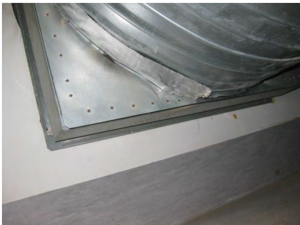
Kuva 66 Epätiivis liitos konehuoneessa.
