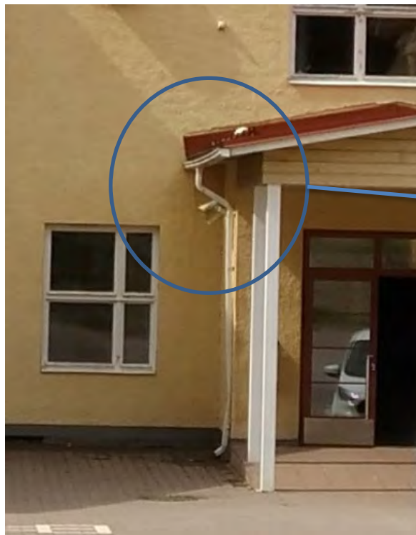
Kuva 34 Pääsisäänkäynnin räystäskourun vuotojälkiä (A-osa).
