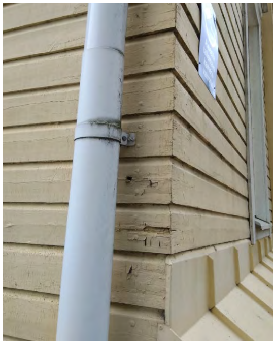
Kuva 30 Puukoulun ulkoseinäkseen vuotaneen syöksytorven aiheuttamaa vauriota.
