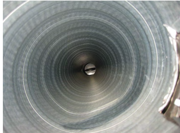
Kuva 75 Tuloilmakanava, L-osa tekninen työ
