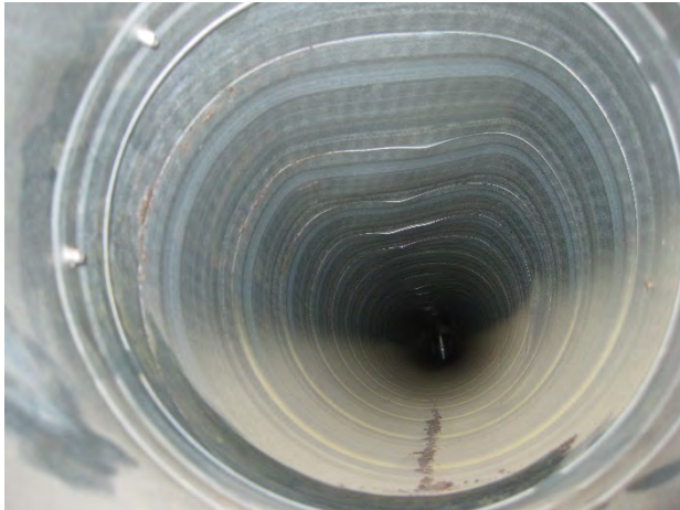
Kuva 74 Tuloilmakanava, L-osa käytävä. Kanava painunut.
