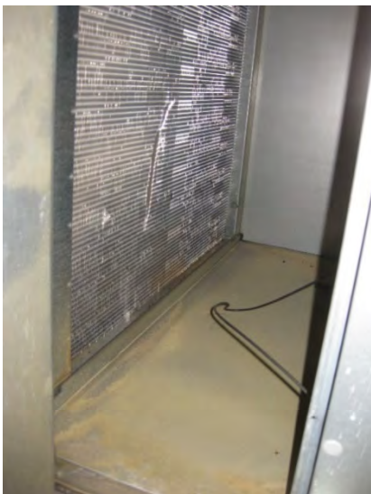
Kuva 78 Siitepölyä LTO:n ja lämpöpatterin välissä. LTO-kennossa painuma
