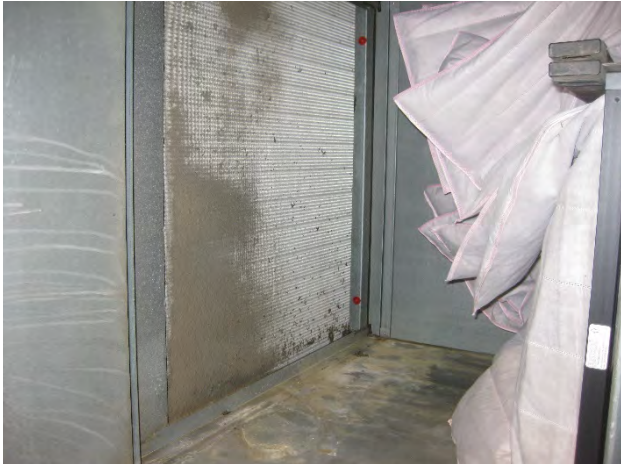
Kuva 76 Suodattimien ohivirtauksesta johtuen likaa lämpöpatterissa
