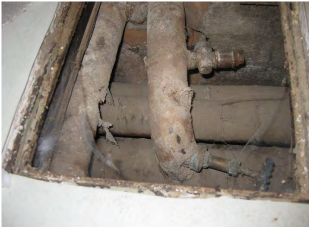
Kuva 19 Putkien eristeet saattavat sisältää asbestia. Haitta-aineet eivät kuuluneet tilattuun tutkimukseen.
