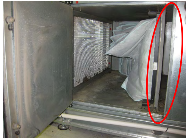
Kuva 63 TK03 ohivirtaus suodatinkammiossa, likaa lämpöpatterissa.
