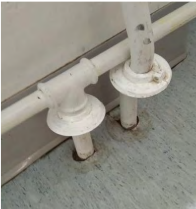
Kuva 61 Putkien läpivientejä ei ole tiivistetty.
