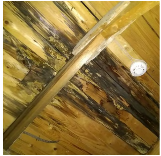
Kuva 45 Vanhoja vesivuotojälkiä kivikoulun (A-osa) ruodelaudoituksessa.
