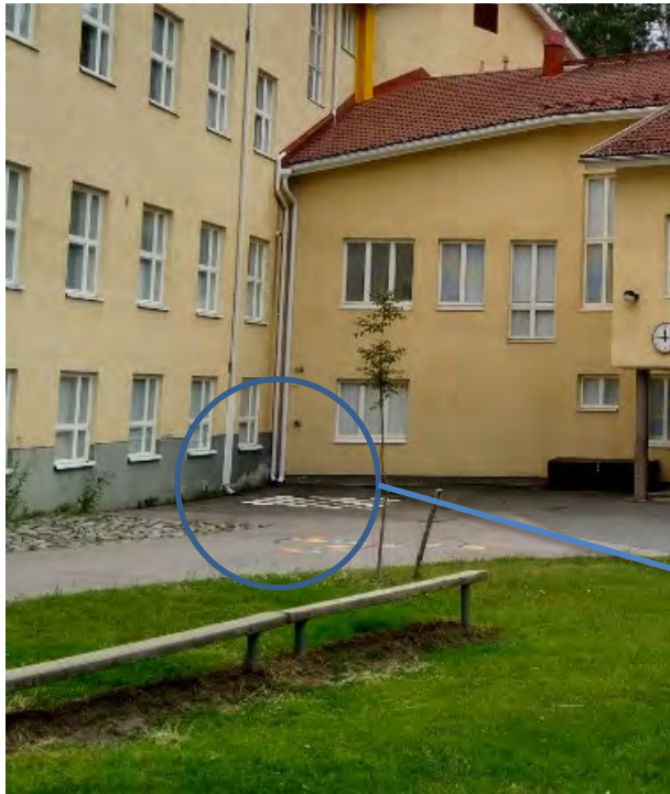
Kuva 10 Runsaalla sateella pihan hulevedet ohjautuvat asfalttia pitkin rakennuksen nurkkaan.
