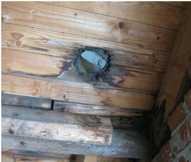
Kuva 44 Vanhan läpiviennin vesivuotojälkiä kivikoulun (A-osa) ruodelaudoituksessa.
