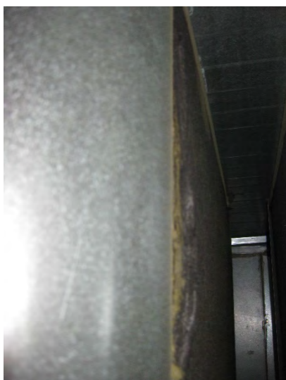
Kuva 72 Äänenvaimentimen pinnoite vaurioitunut
