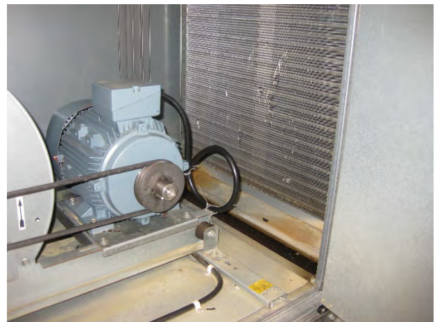
Kuva 79 TK02, 1 kiilahihna (2 uraa). Kiilahihnassa havaittiin murtumia
