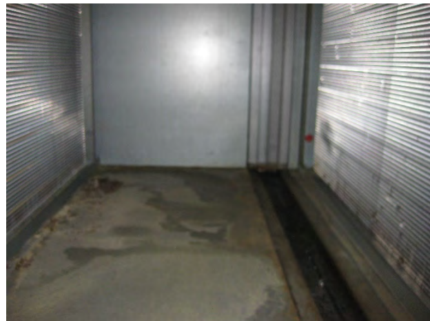
Kuva 71 LTO:n ja lämpöpatterin välissä siitepölyä / öljyä
